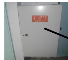
⑦放水口 (消防隊専用)
