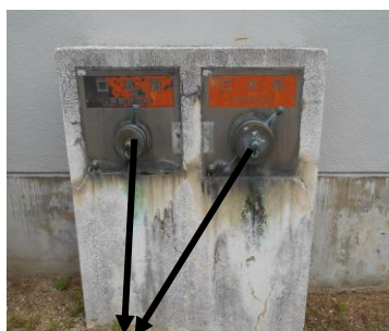
①連結送水口（消防隊専用）
